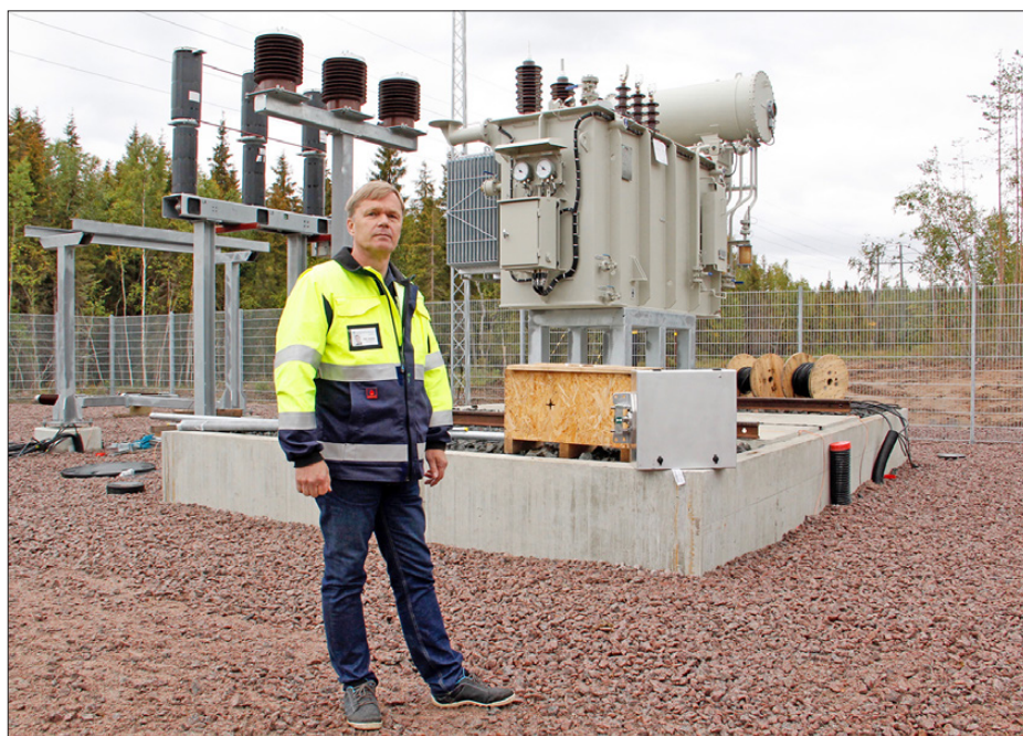
Tornionlaakson Sähkö Oy:n rakennuspäällikkö Jaakko Isto ja Jolmankosken voimalaitokselle valmistuva, uusi sähköasema.
