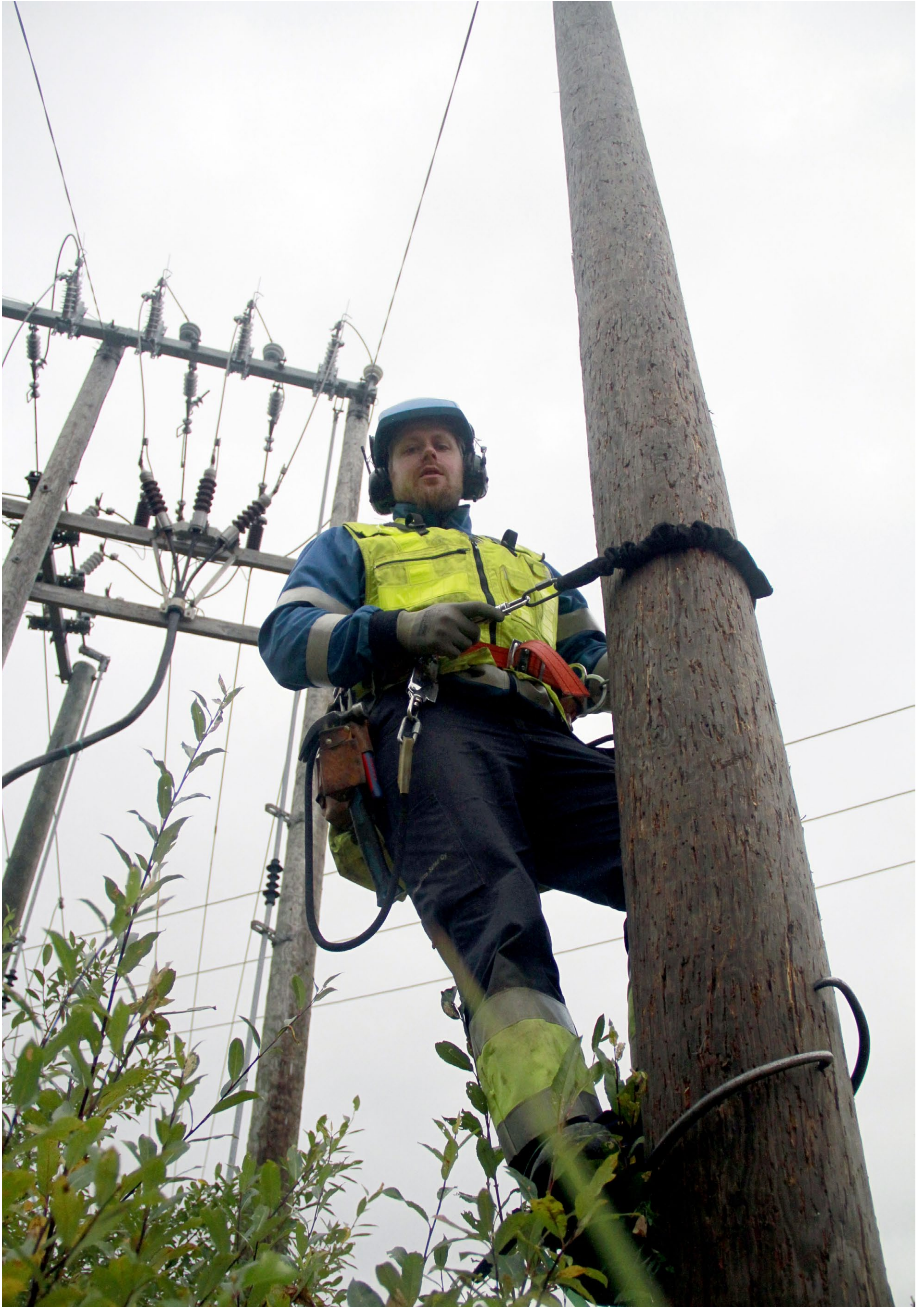
Ville Koskenniemi rakentaa useimmiten uutta linjaa, mutta hallussa on myös perinteinen tolppiin kiipeäminen.
